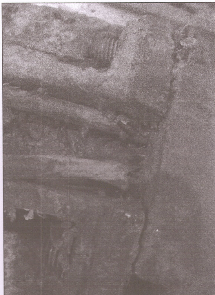
FIGURA 6 – REGISTRO DE OXIDAÇÃO NO EQUIPAMENTO
