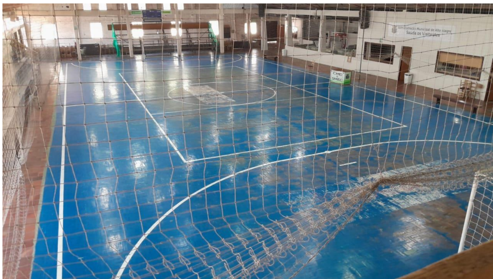
FOTO 01- TONALIDADE PINTURA QUADRA- Quadra Esportiva do Salão Paroquial
