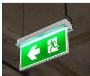
ILUMINAÇÃO DE BALIZAMENTO DIRECIONAL
