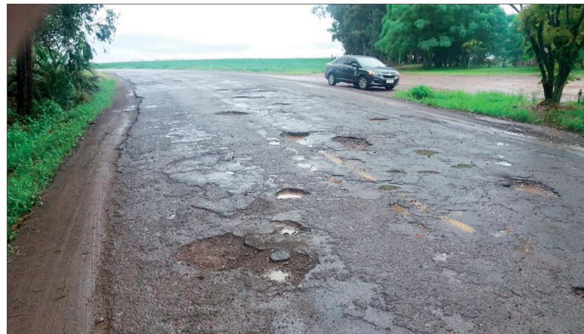
Asfalto da VRS 817 está péssimo em vários trechos
