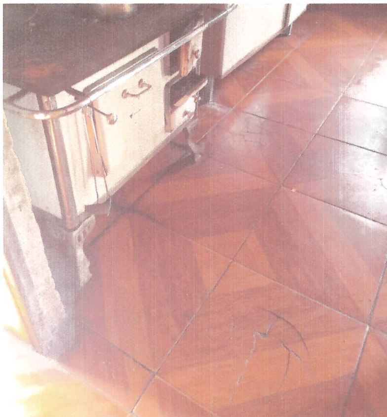
Figura 3 Piso cozinha danificado e infiltrado
