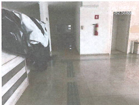
Fotografia 4. Piso molhado e mobiliário protegido após o vazamento.
