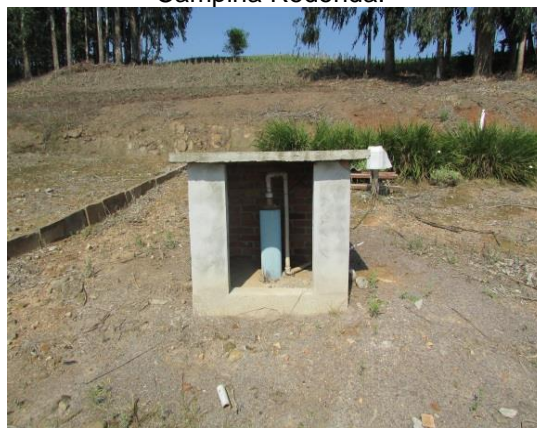
Figura 2.13 - Ponto de captação da Campina Redonda.
