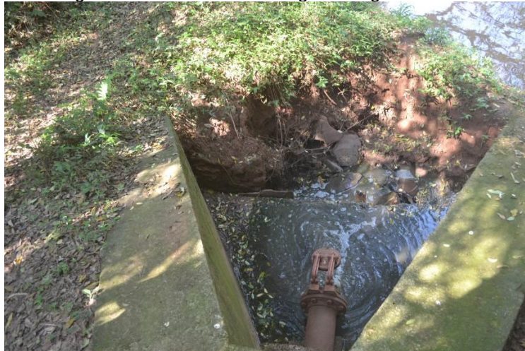
Figura 3.7 - Ponto de descarga do esgoto tratado.
