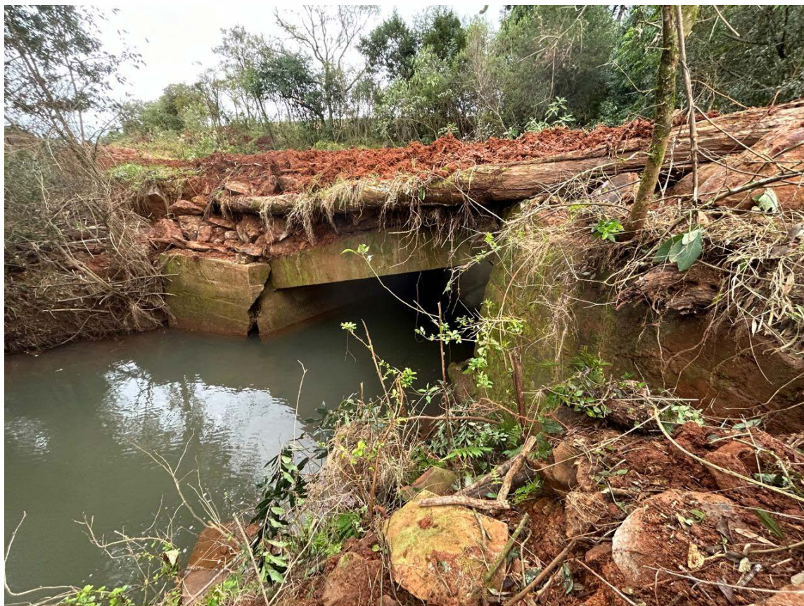
Foto 01 – Situação da ponte após a enchente (02/05/2024)
