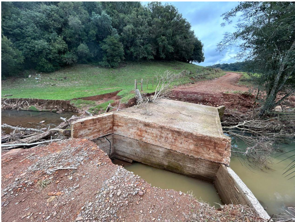
Foto 02 – Situação da ponte após o colapso (02/05/2024)
