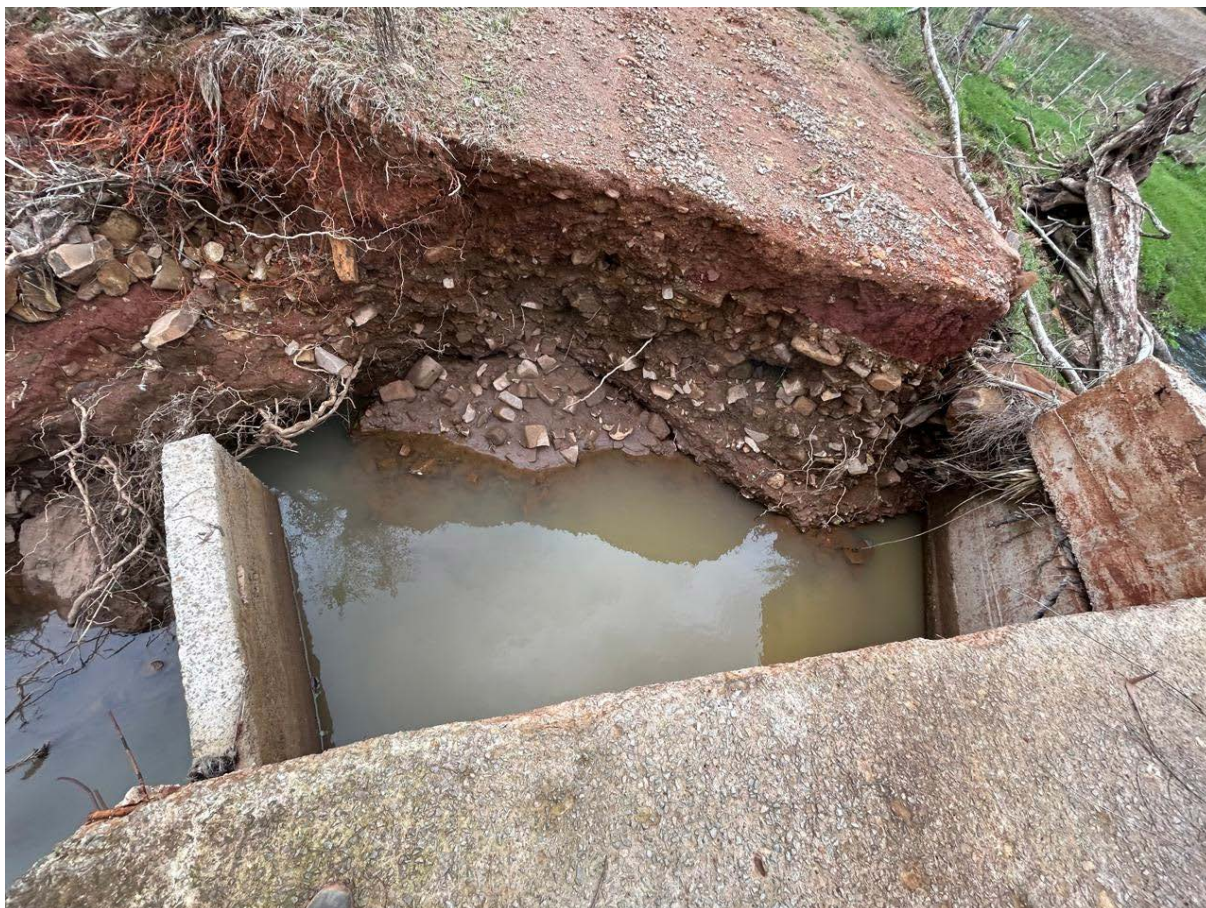
Foto 01 – Situação da ponte após o colapso (02/05/2024)
