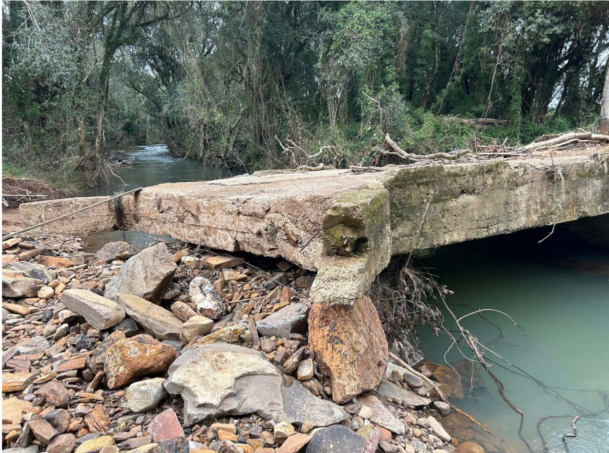
Foto 02 – Situação da ponte após o colapso (02/05/2024)
