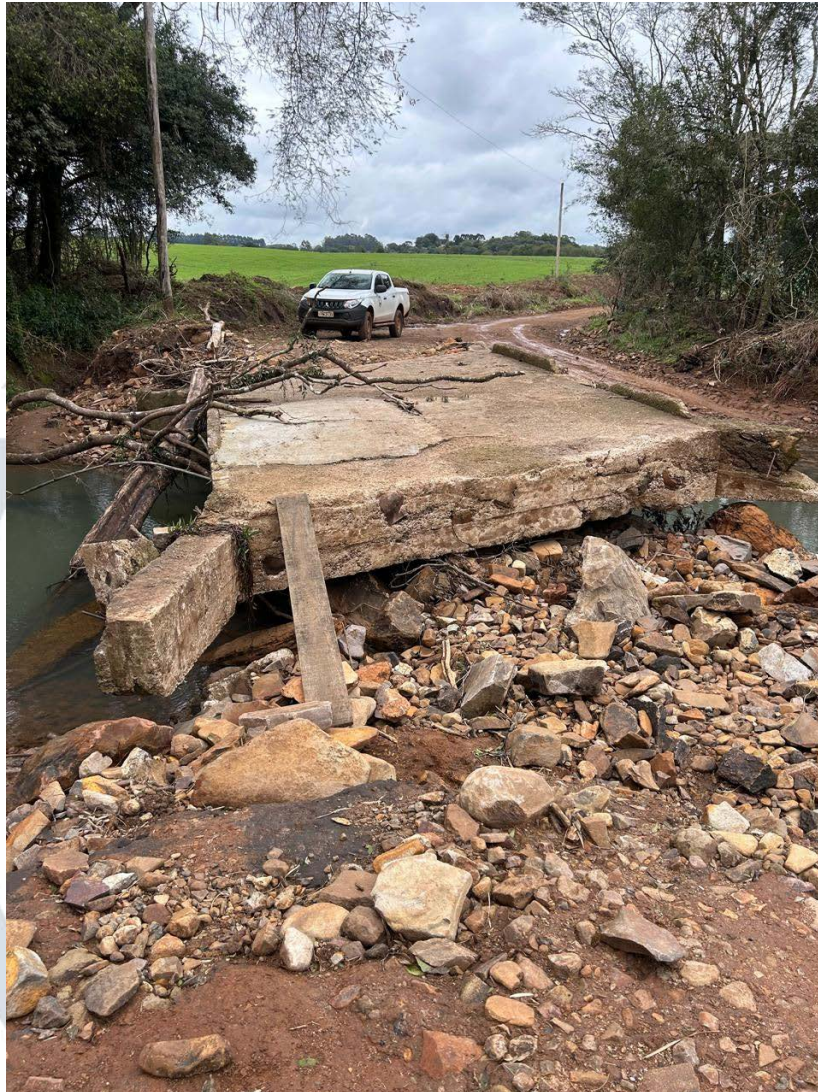
Foto 01 – Situação da ponte após o colapso (02/05/2024)
