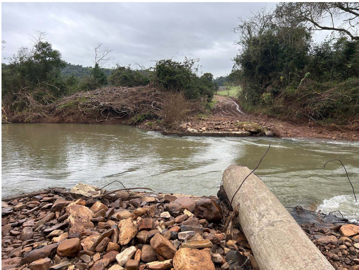
Foto 01 – Situação da durante o colapso (02/05/2024)
