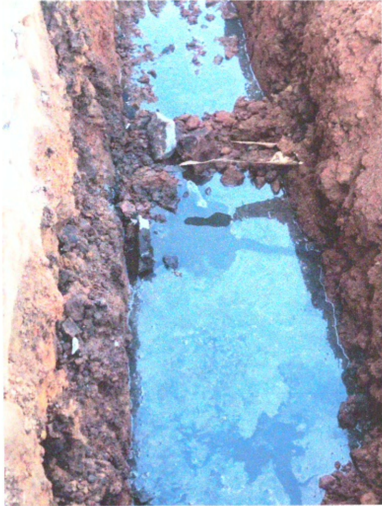
Foto de 18 – Esgoto a céu aberto
