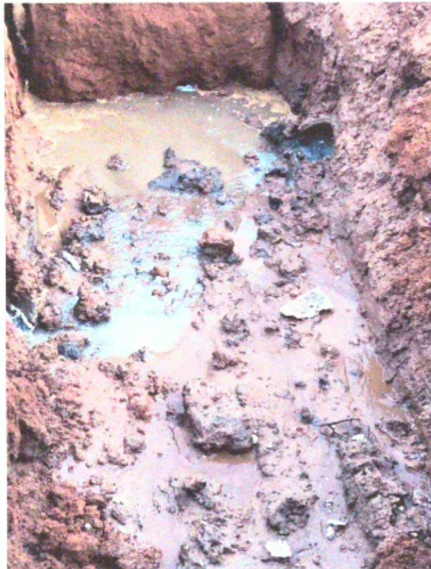
Foto de 20 – Esgoto a céu aberto
