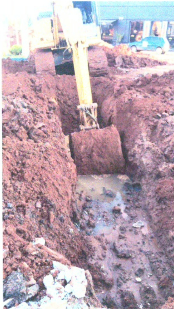
Foto de 21 – Esgoto a céu aberto
