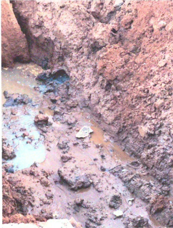
Foto de 15 – Esgoto a céu aberto
