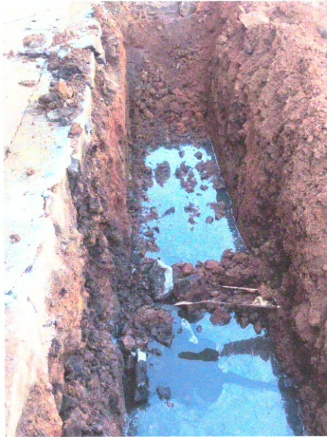
Foto de 16 – Esgoto a céu aberto
