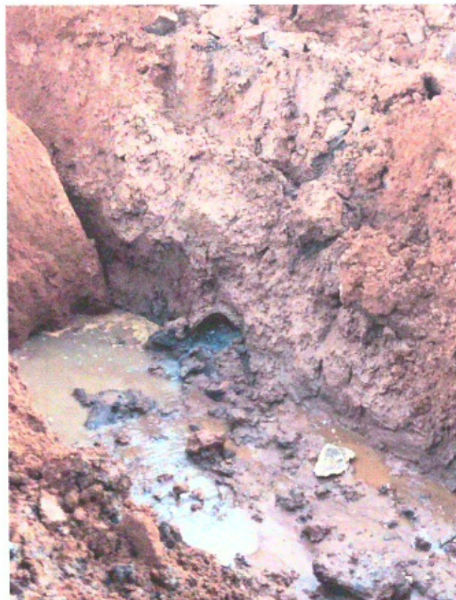
Foto de 17 – Esgoto a céu aberto
