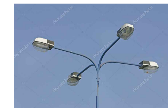
Poste alto tipo pétala
