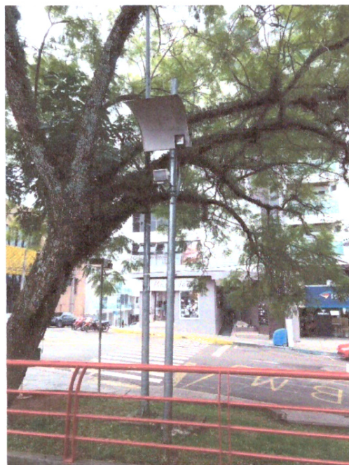
Figura 1 – Luminárias de descarga de alta intensidade e LED, dispostas em poste com aproximadamente 5m de altura.
