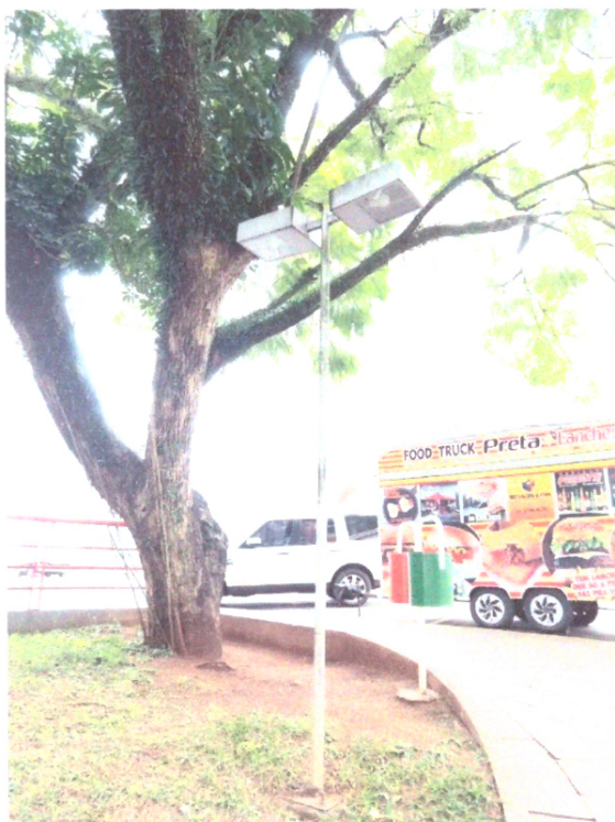
Figura 3 – Luminárias de LED dispostas em poste com aproximadamente 2,5m de altura.
