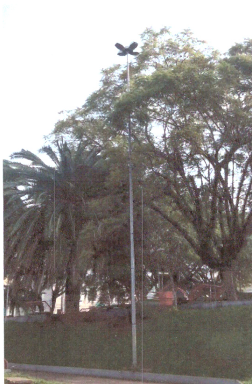
Figura 4 – Luminárias de vapor de sódio, dispostas em poste com aproximadamente 9m de altura.
