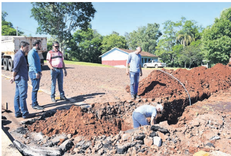
Ligação da rede de água teve obra iniciada no Parque da Faguense
