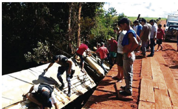
Carreta caiu de uma ponte de madeira no município de Paranatinga (MT)
