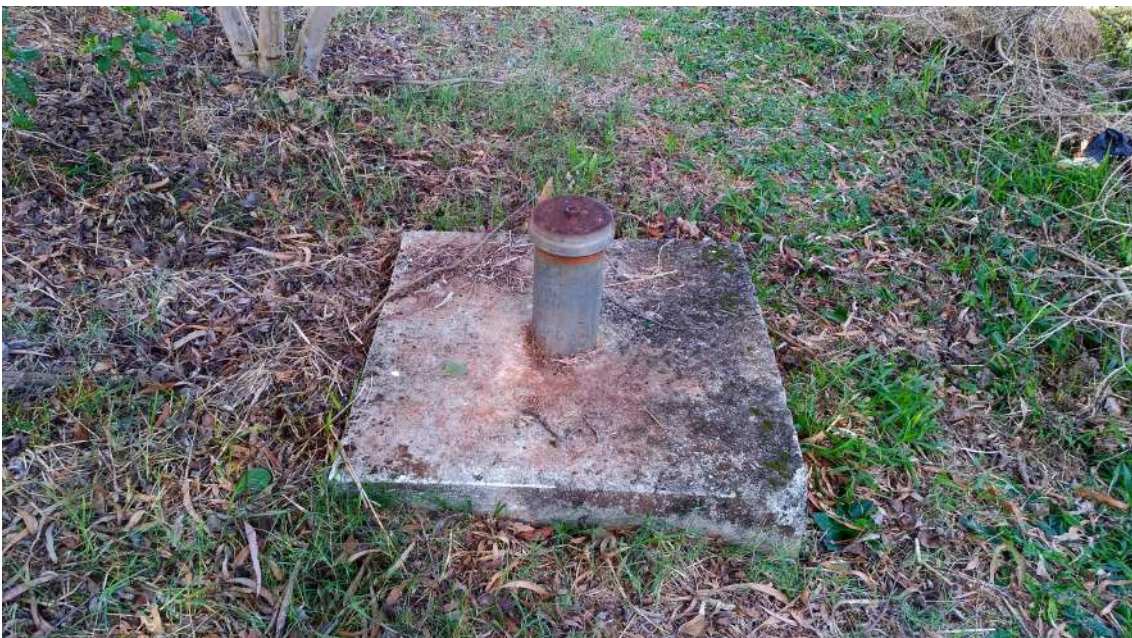
Poço de monitoramento – PM 04
