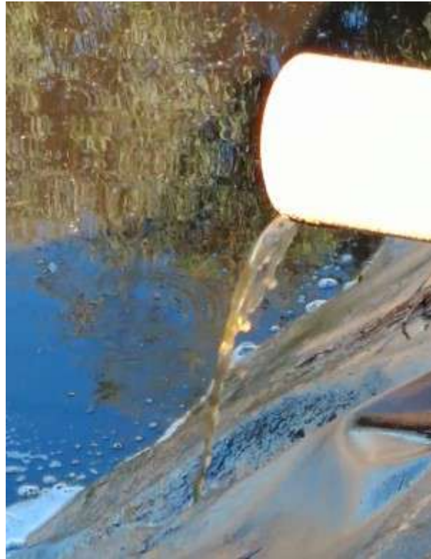
Figura 4: Vista do talude erodido. No fundo da Lagoa 3 aparece resíduos de solo que deslizou a partir do talude.
