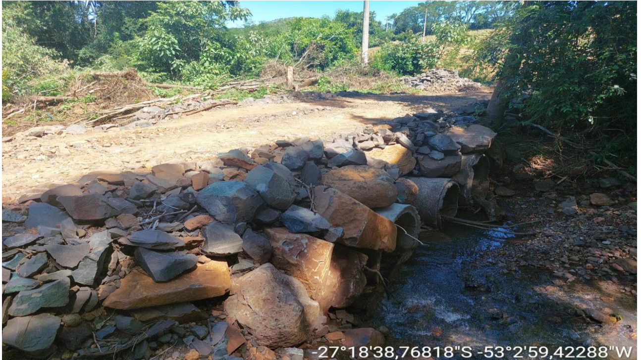
Figura 02: Situação atual da cabeceira do pontilhão.
