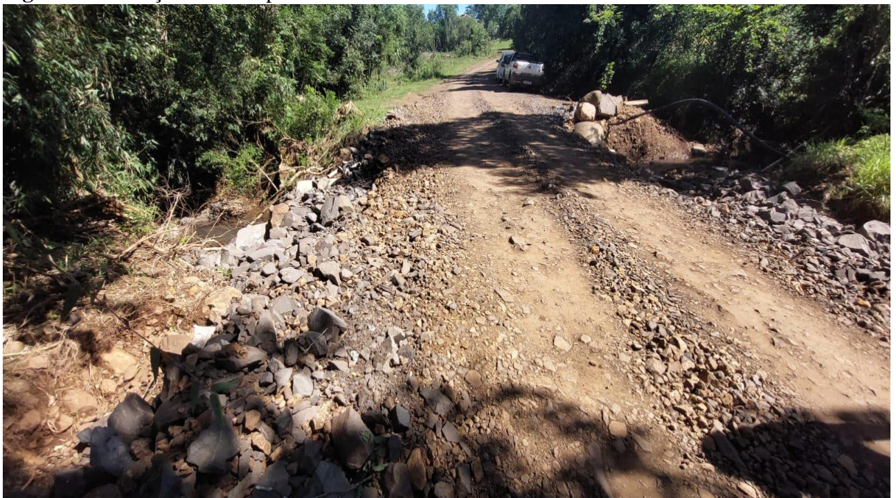
Figura 01: Situação atual do pontilhão.
