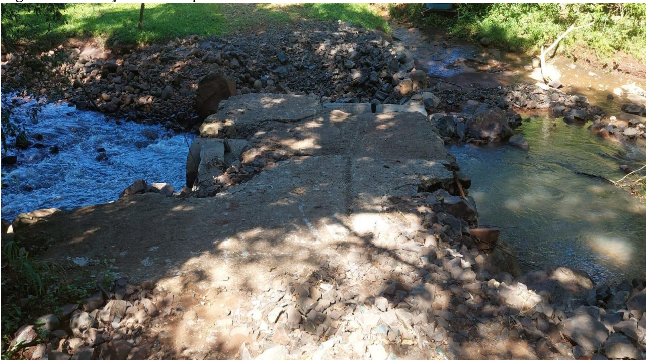
Figura 01: Situação atual do pontilhão.
