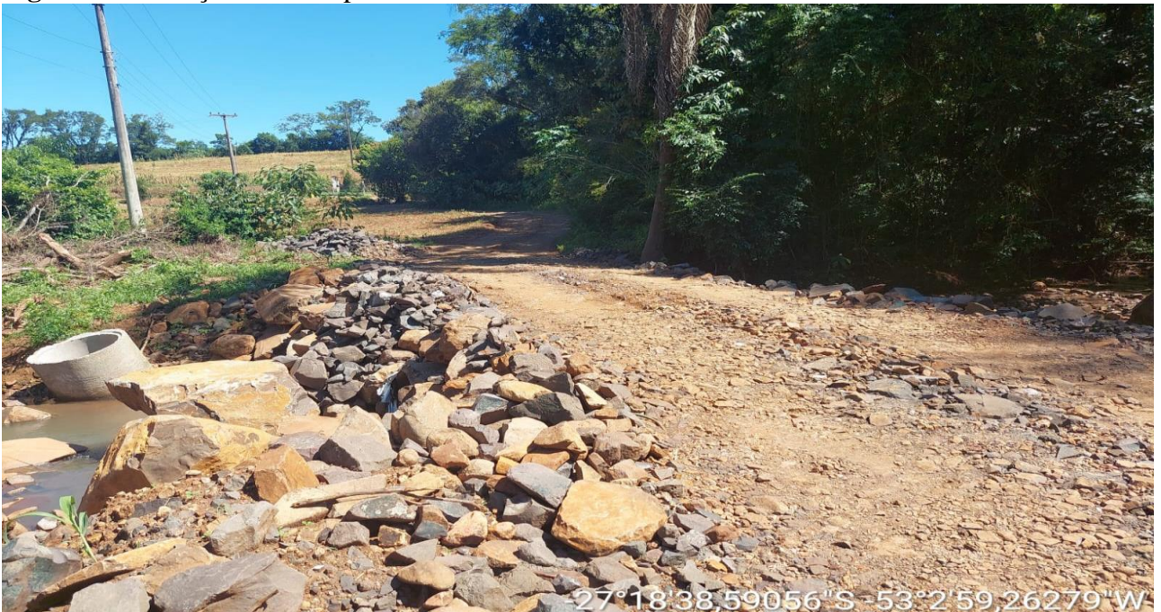
Figura 01: Situação atual do pontilhão.
