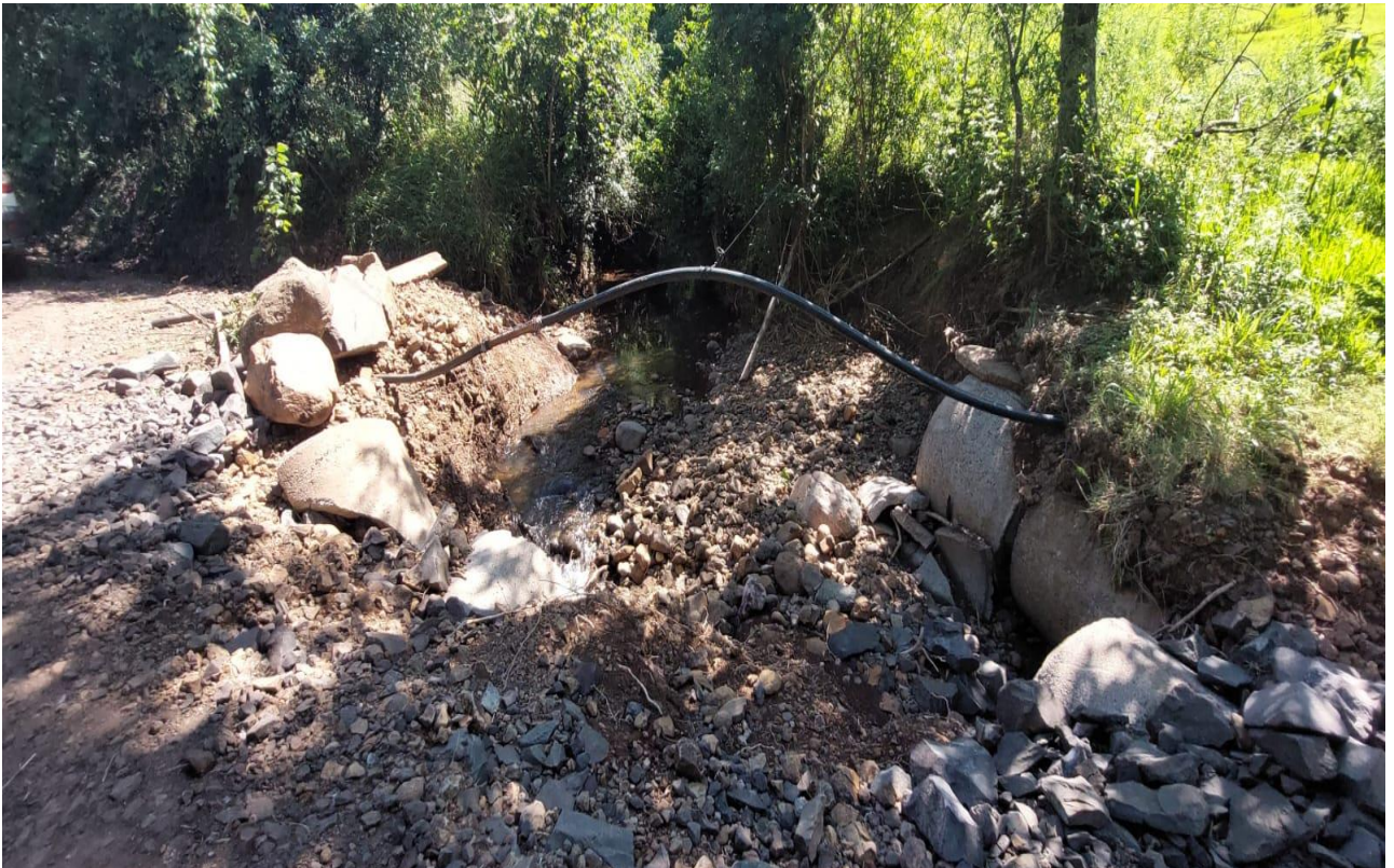
Figura 03: Situação atual do pontilhão.
