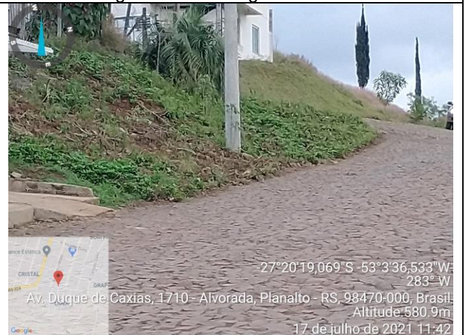
Figura 16 – trecho sem meio-fio
