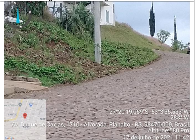
Figura 16 – trecho sem meio-fio
