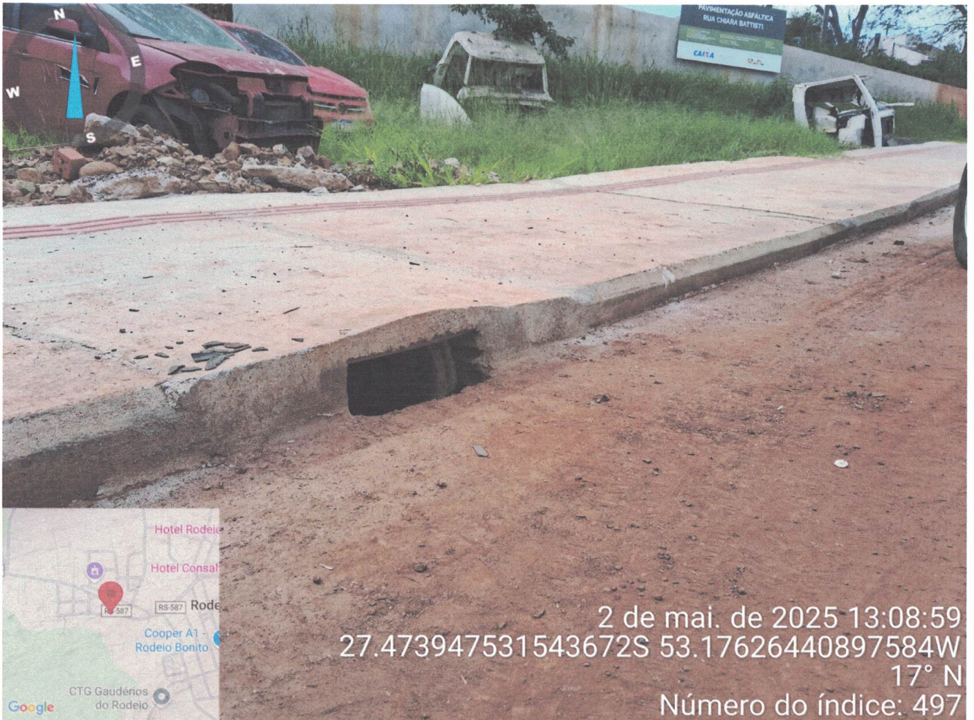
Figura 2 - Captação de água
