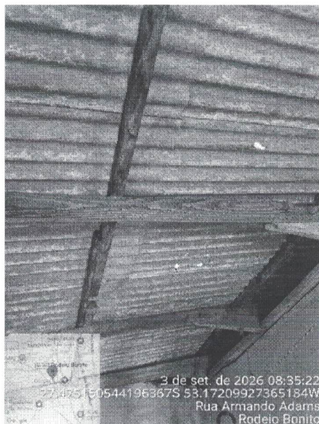
Figura 10 — Primeiro detalhe do segundo núcleo de registros na Rua Armando Adams, com perfuração em telha de fibrocimento.
