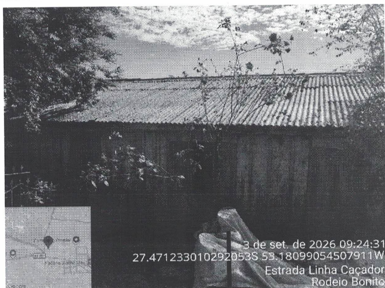
Figura 4 — Segundo registro externo na Estrada Linha Caçador, mostrando residência de madeira e a condição da cobertura. Data/hora visível: 03/09/2026, 09h24min31s. Coordenadas: 27.4712330° S; 53.1809905° W.
