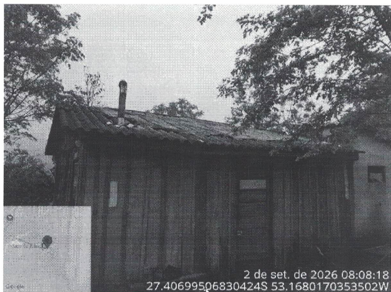
Figura 1 — Conjunto A: vista geral de residência de Maria Ines de Quadros, Linha Peixeiro, com lona aplicada provisoriamente sobre parte da cobertura.
