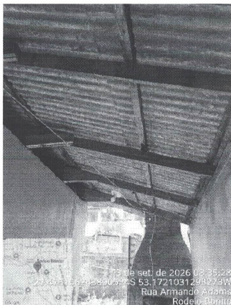
Figura 11 — Segundo detalhe do mesmo núcleo, mostrando fissuras e pontos de passagem de luz pela cobertura.
