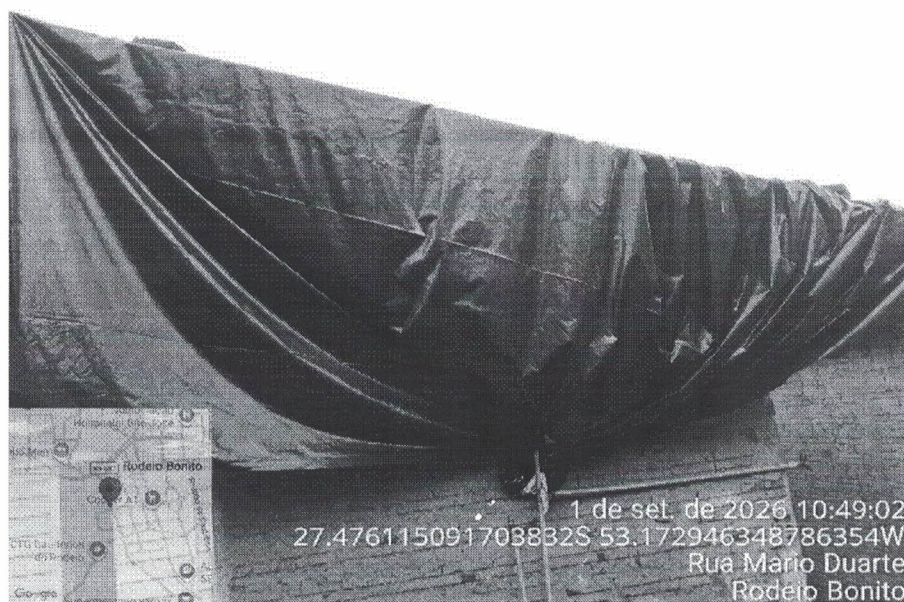
Figura 4 — Primeiro registro do imóvel na Rua Mario Duarte, com proteção emergencial de lona sobre a cobertura.
