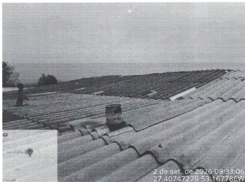
Figura 4 — Conjunto C: vista da cobertura com telhas danificadas de Nezélia de Quadros, com reparos provisórios em diversos pontos.
