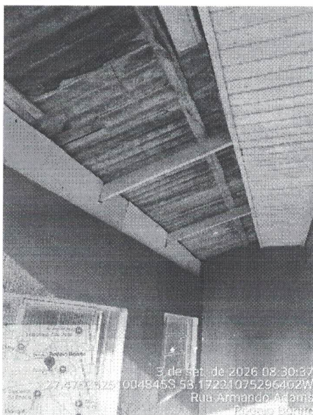
Figura 9 — Vista inferior da cobertura no primeiro núcleo da Rua Armando Adams, com telhas fissuradas e perfuradas. Data/hora visível: 03/09/2026, 08h30min37s. Coordenadas: 27.4752525° S; 53.1722108° W.
