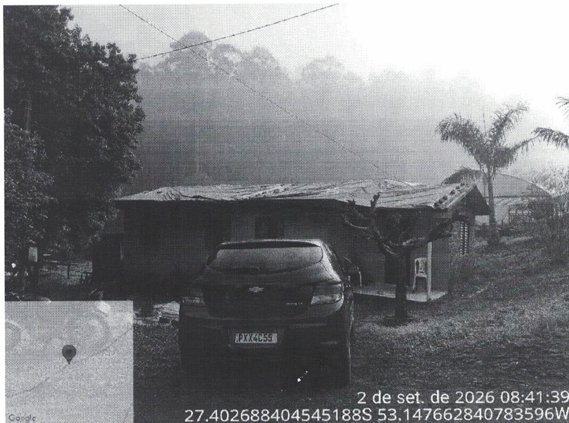
Figura 3 — Conjunto B: residência na Linha Peixeiro de Jose Noé de Quadros, com extensa proteção emergencial de lona sobre a cobertura.
