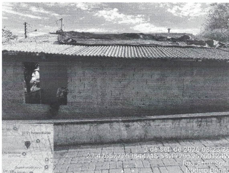
Figura 12 — Imóvel identificado na Rua Artur Sotili, com lona instalada provisoriamente sobre parte da cobertura. Data/hora visível: 03/09/2026, 08h23min28s. Coordenadas: 27.4765773° S; 53.1729597° W.
