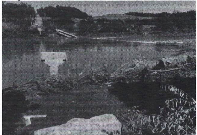
VISTA DA PONTE: APÓS A QUEDA
