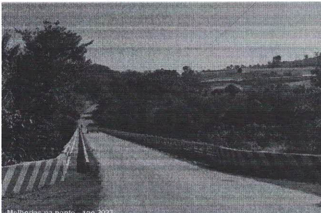
Melhorias na ponte - ago 2023 VISTA DA PONTE: ANTES DA QUEDA
