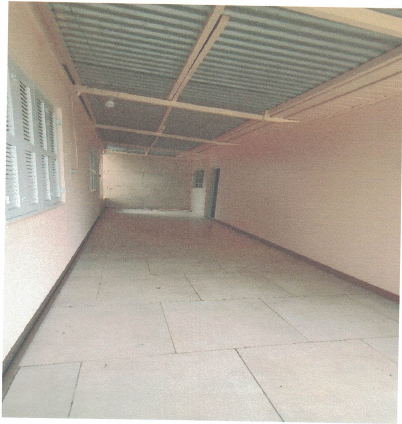
Área de ligação entre a casa com área de serviço, adega e garagem
