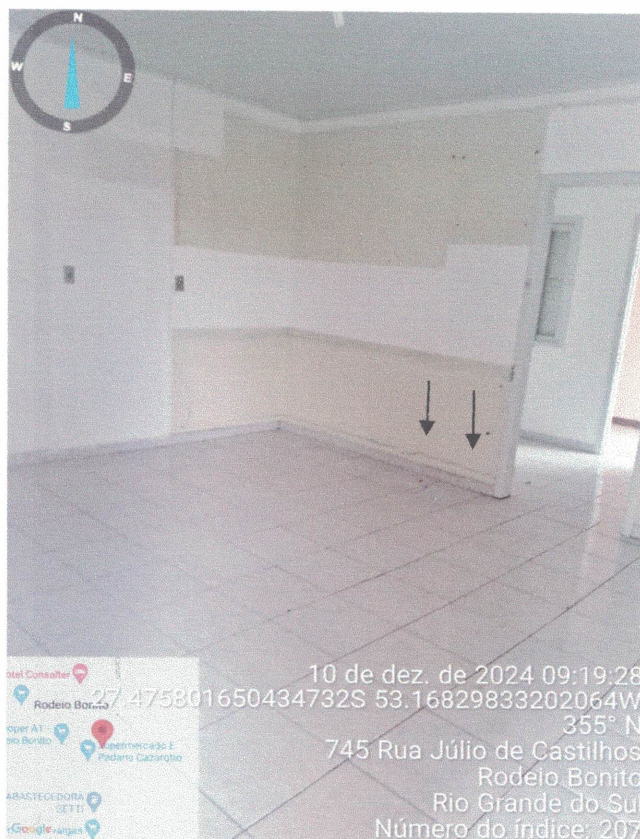
Imagem 07 – Recalque grave encontrado na cozinha
