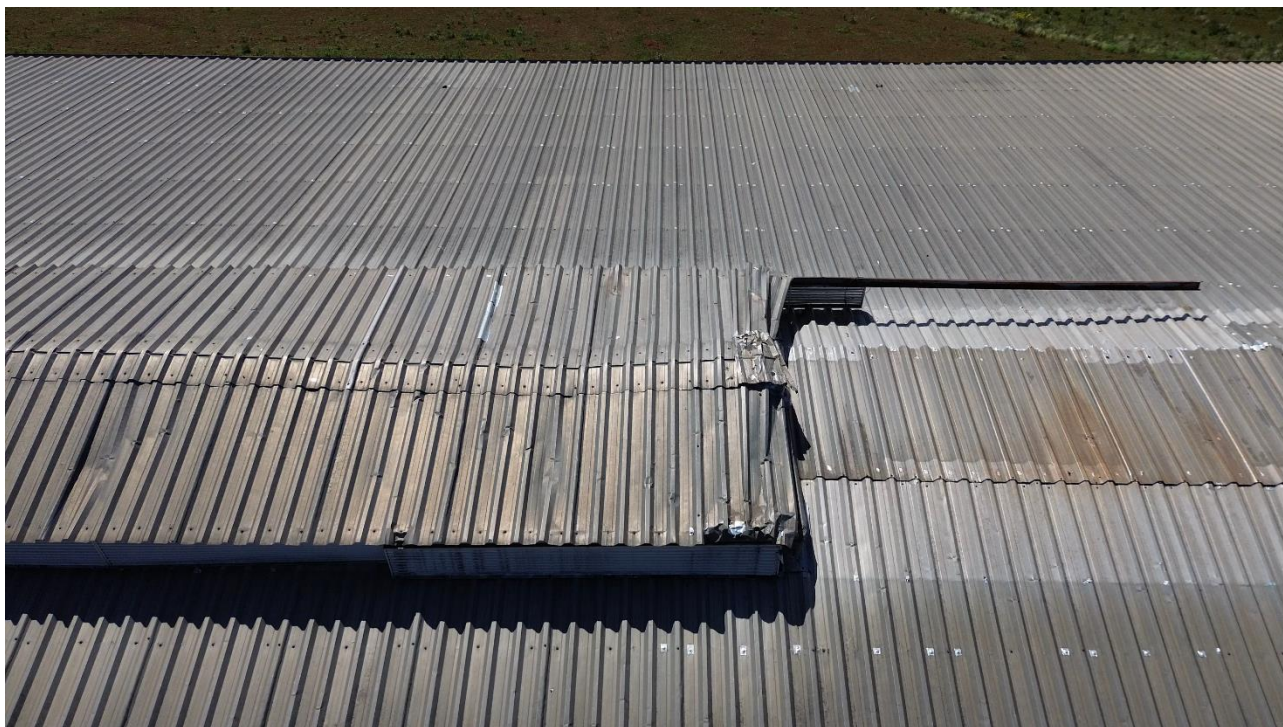
Imagem 3 externa – mesmo local que imagem 1 e 2 na parte externa – telha amassada no lanternim e cumeeira em chapa reta sem manta de vedação.
