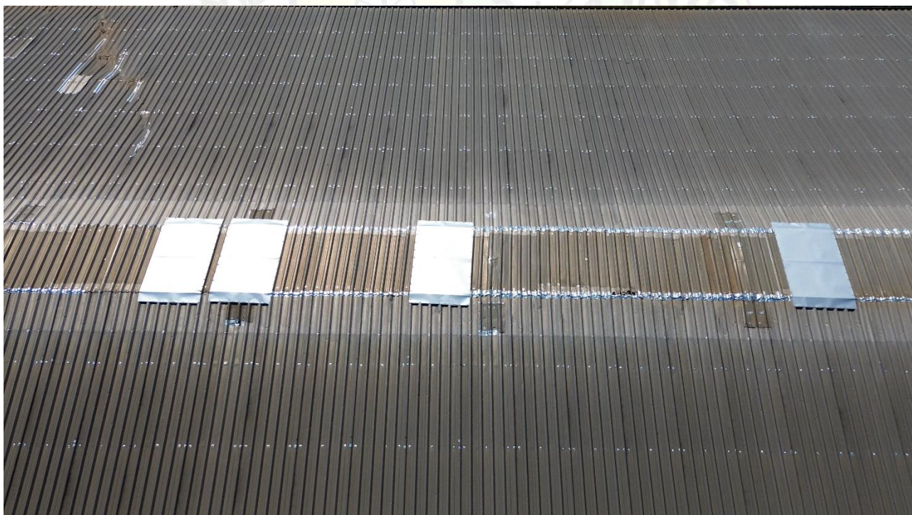
Imagem 4 externa – imagem da cumeeira reta com acabamento de manta na emenda da cumeeira com o telhado, várias emendas em chapa lisa, colocadas sobrepostas.
