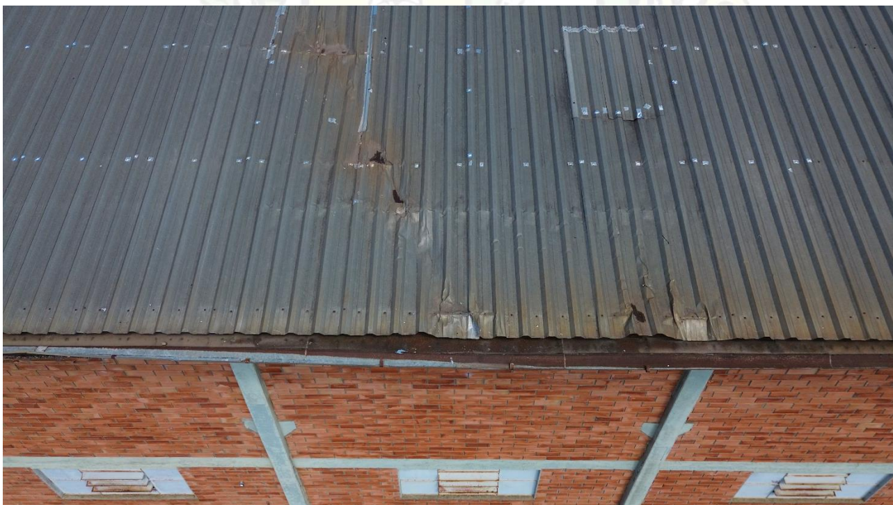
Imagem 6 externa – telhas amassadas e furadas na água do fundo – mais ao meio do pavilhão (imagem mais aproximada da imagem 5)
