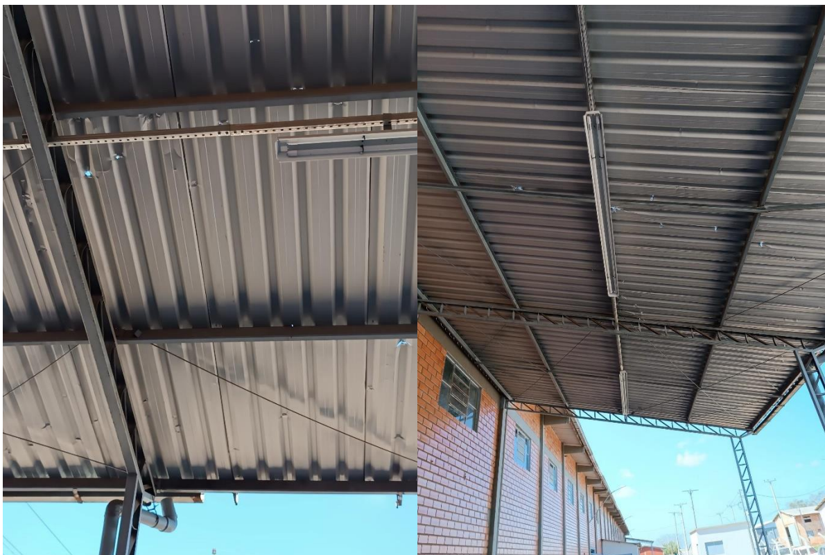
Imagem 9 externa – varanda da doca com amassamento de telhas e vários furos
