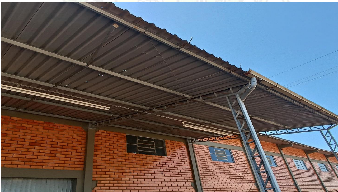
Imagem 10 externa – varanda da doca com calha parcial e sem conectar a descida
