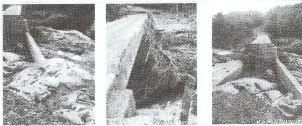
Fotos 1 a 6 – Situação atual da Ponte sobre o Rio Tabajara
