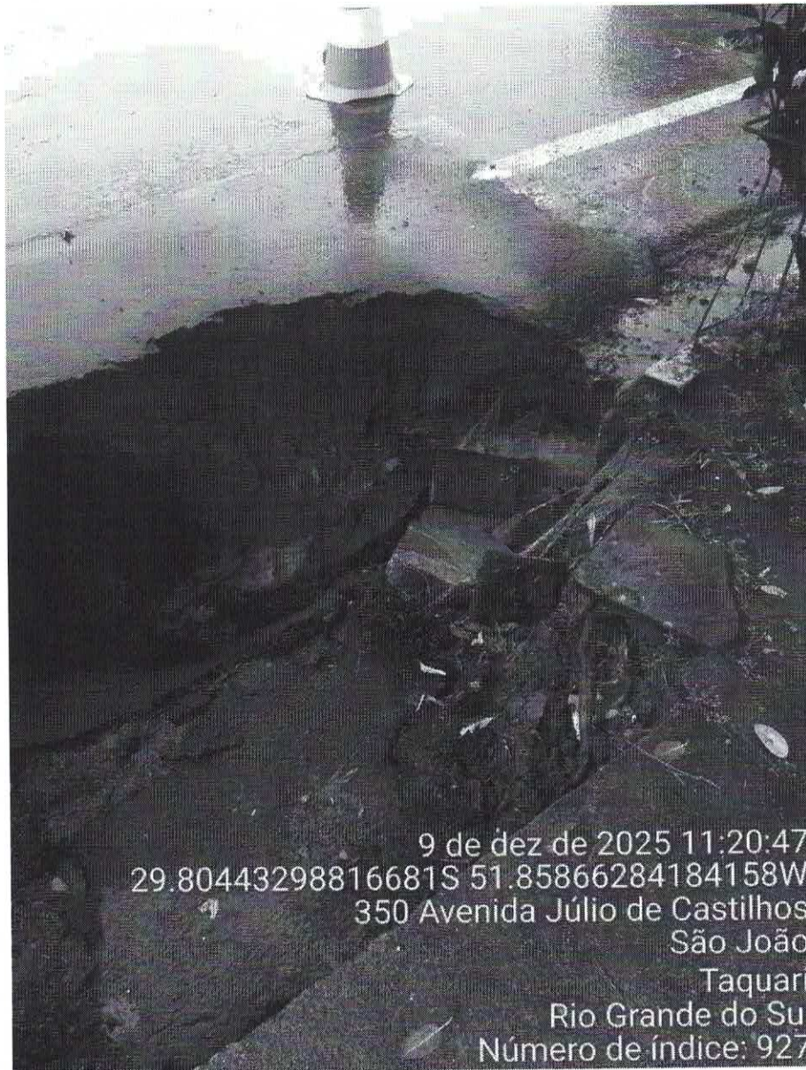
Foto 03: Vista da área onde houve rompimento da tubulação da Corsan.
