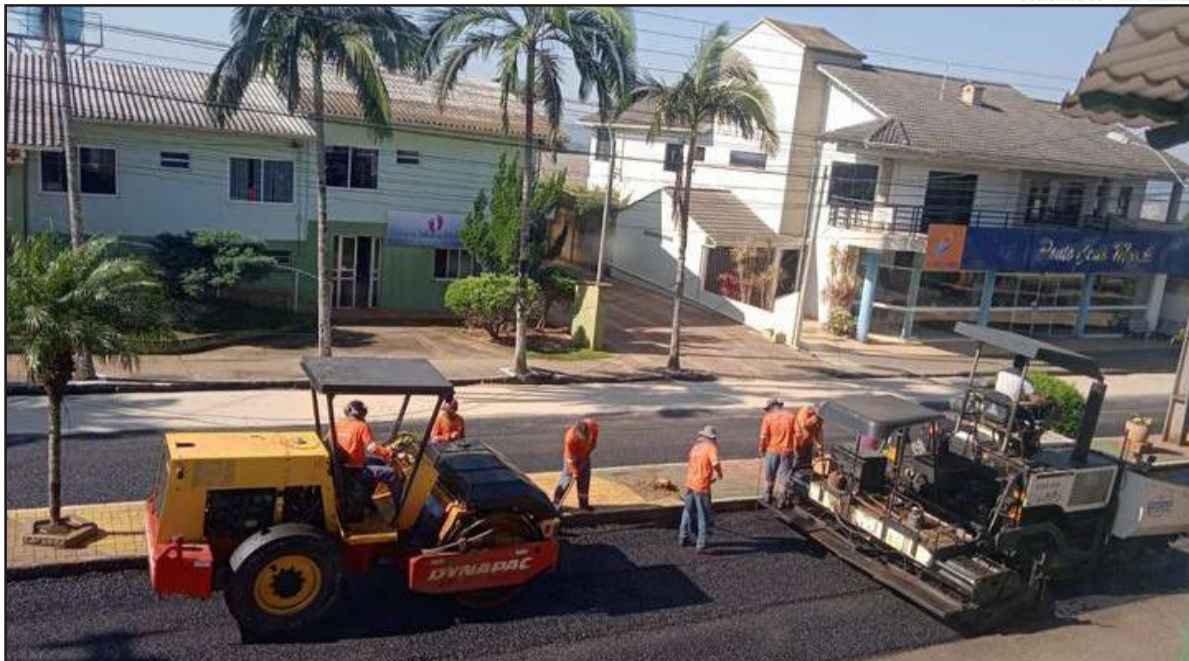
Essa é a segunda etapa das obras para melhoria da principal avenida da cidade
